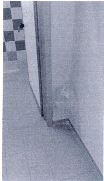
foto 14: Umidità da risalita, esterni ed interni
